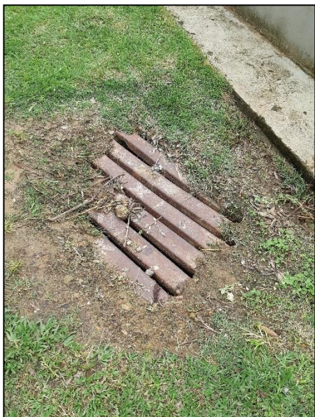
FIGURA 344 - BOCA DE LOBO PRÓXIMO A ETE CAPELA DO JACU FONTE: ACERVO DO AUTOR, 2021
